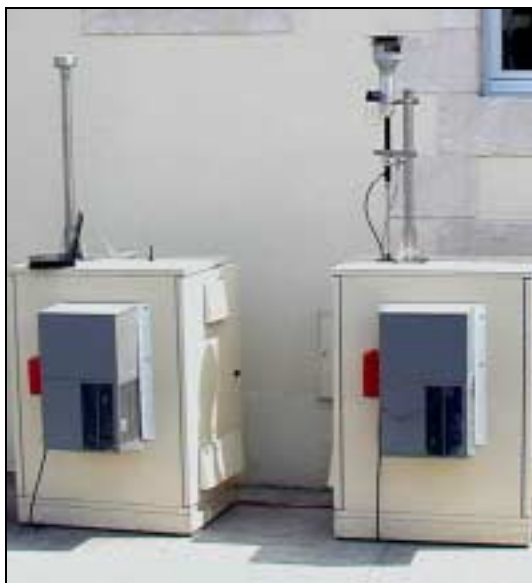
Figure 11 : photo des cabines mobiles contenant les analyseurs automatiques de NO x , PM 10 et CO
