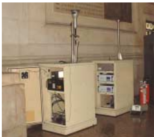
Armoires de mesures intérieures situées dans le hall de départ
